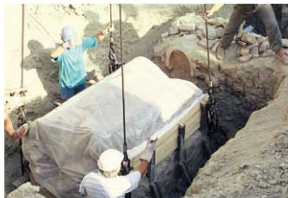
Απόσπαση τμήματος του υδραγωγείου.
